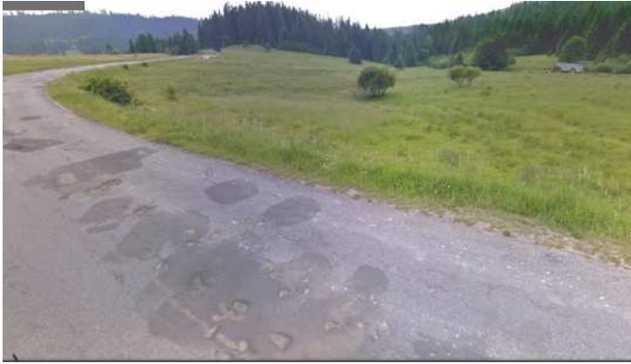
Zły stan nawierzchni na DW957 w gminie Jabłonka – widoczne liczne ubytki w nawierzchni jezdni.
