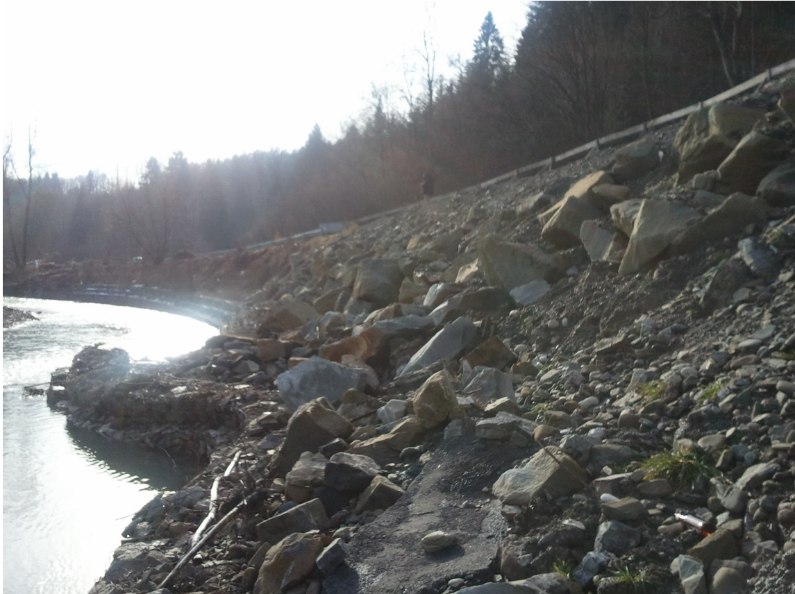
Fot. 1 Zniszczony gabion u podstawy nasypu drogowego
