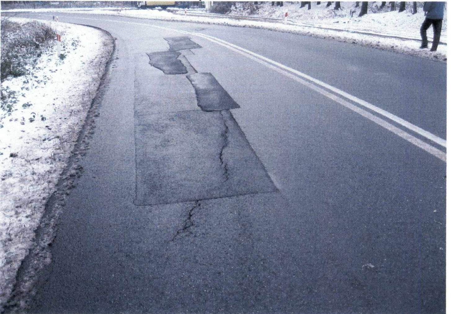
Fot. 2 Spękania i nakładki na nawierzchni bitumicznej
