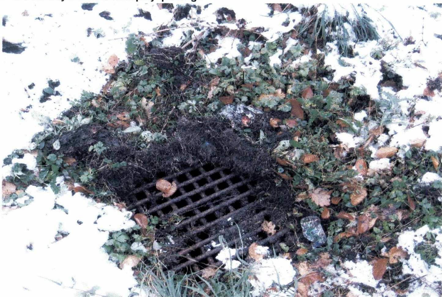
Fot. 4 Niedrożny wlot do przepustu pod drogą
