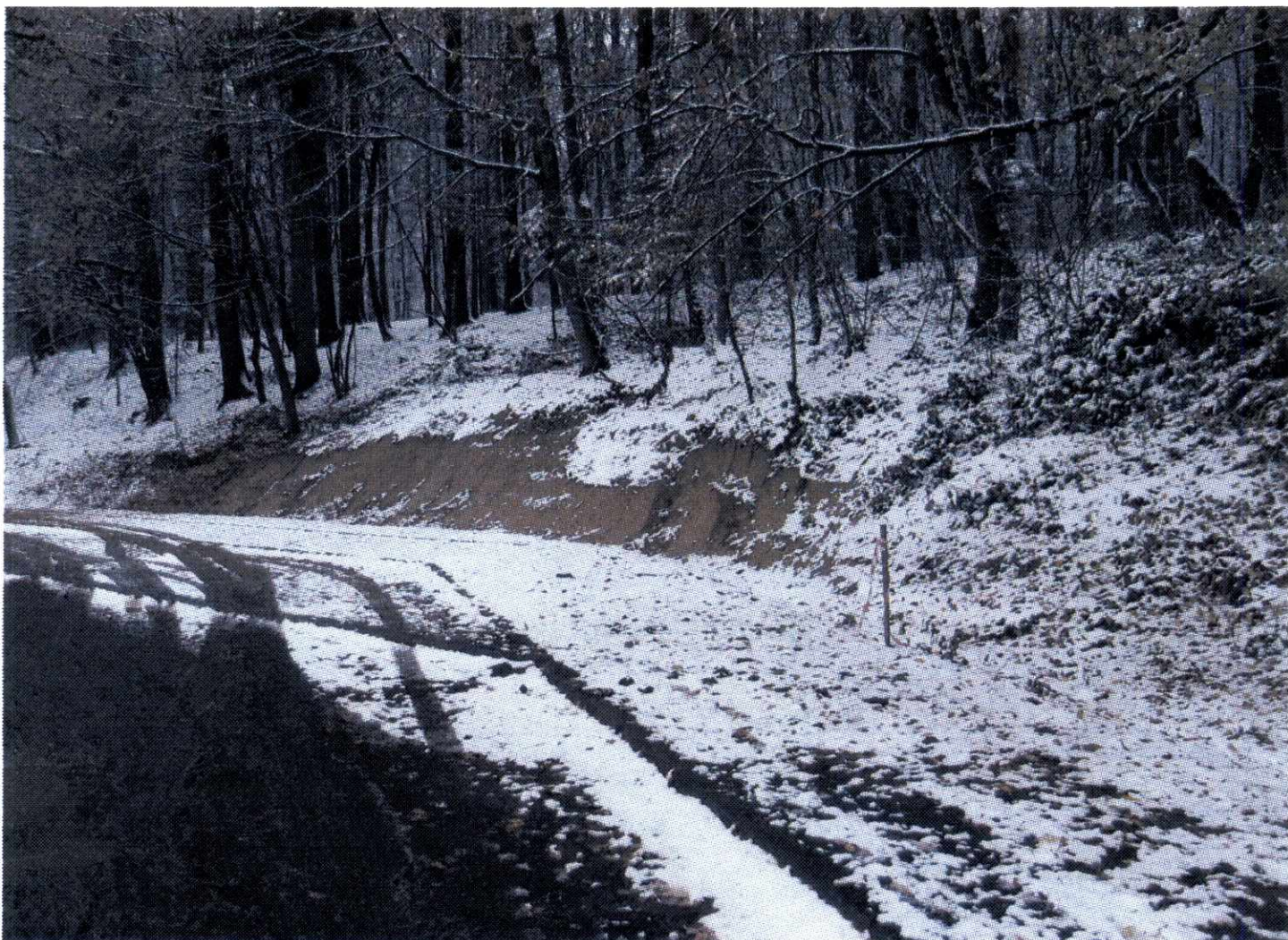
Fot. 3 Nieaktywne osuwisko przy parkingu
